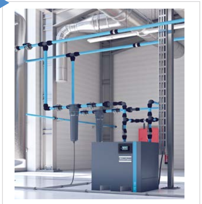
INSTALACIONES Y MANTENIMIENTO
